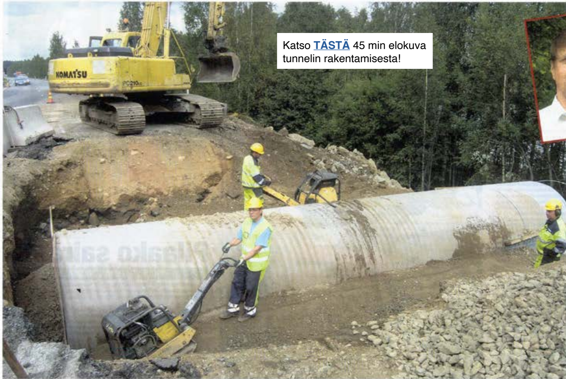
Yleiselle tielle piti tehdä kiertoreitti tunnelityömaan ajaksi. Lisäksi tunneli oli rakennettava kahdessa osassa.
